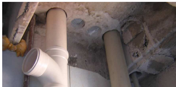
Figura: Furos da coluna de ventilação e ramal (desnecessários)
